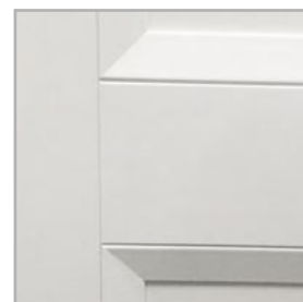
faza na łączeniu ramiaków
